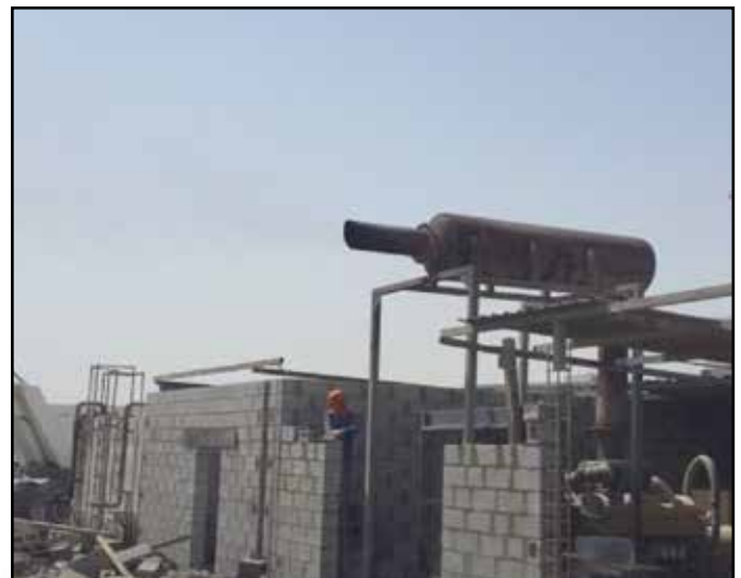
Nach der Installation der micfil Filter.
